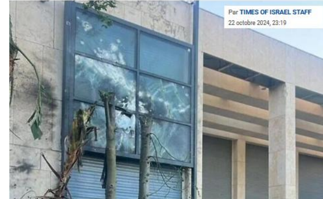
Dommages causés à la maison du Premier ministre Benjamin Netanyahu à Césarée lors d'une attaque de drone du Hezbollah, le 19 octobre 2024. (Autorisation)
